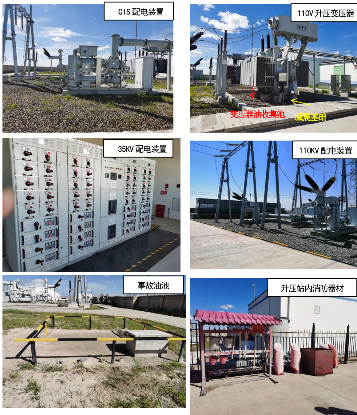
图 4-1 升压站内设备设施现状（调查期 2020 年 8 月）
