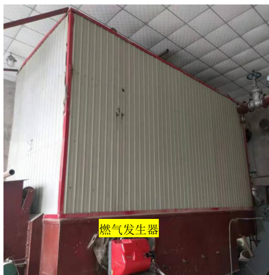
技改后 5t/h 导热油炉
