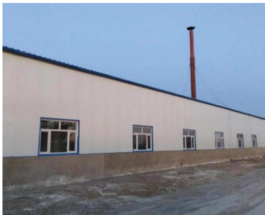
污水处理站排气筒
