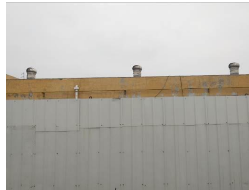
厂房通风设施
