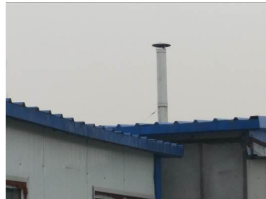
燃气锅炉 10 米高烟囱
